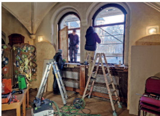
Einbau der sanierten Fenster im östlichen Seitenschiff unten (siehe Seite 19) Foto: C. Dose
