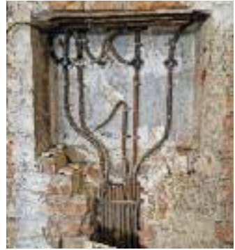
120 Jahre alte Elektroleitungen
