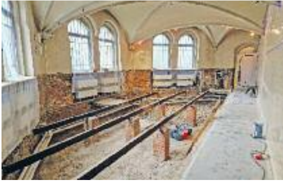
Abgebrochener Fußboden im westlichen Seitenschiff
